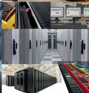
Data Center La solution intégrée
